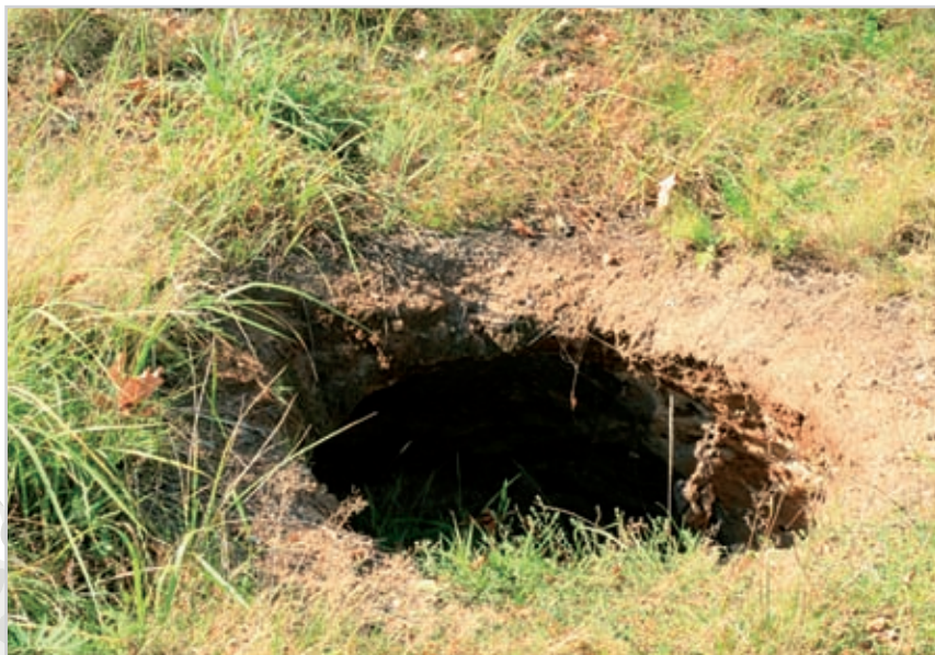
RYC. 42. BOBRZE SZKODY W GROBLI STAWOWEJ. Fot. Waldemar Bena
